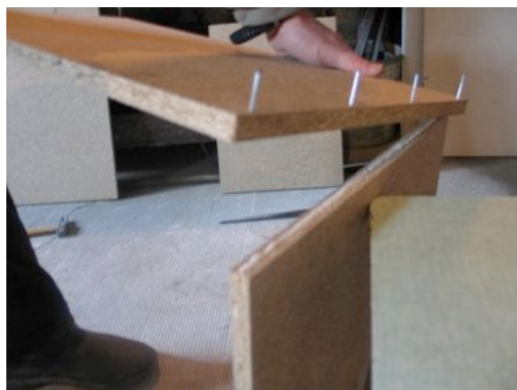
Photo 4 – Poser le côté du panneau C sur la tranche préencollée du panneau E, et clouez.
