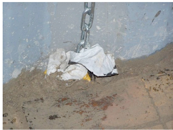
Protection des anneaux de fixation au sol. L'idéal est d'y fixer les chaînes puis de protéger avec du papier.
